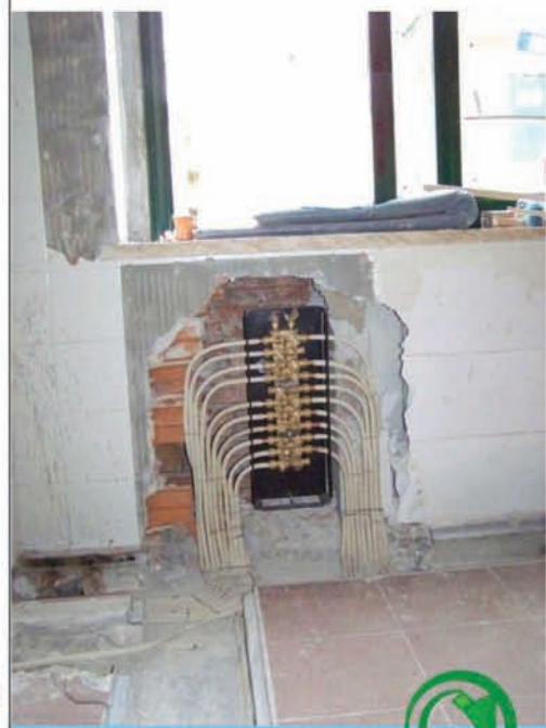
La centralina di comando dell'impianto di riscaldamento
