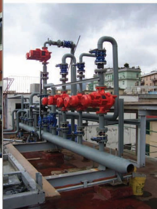
Particolare della centrale termoelettrica installata sul terrazzo di copertura dell'edificio
